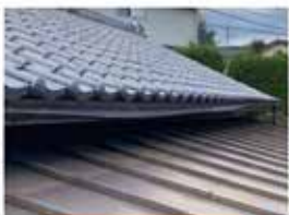
雨樋勾配不良
