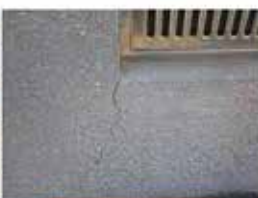
基礎クラック
